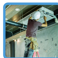
TÉCNICO EM REFRIGERAÇÃO & CLIMATIZAÇÃO
